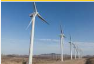
PARC EOLIEN DU TURKANA
